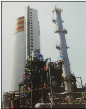
Rör till Urea anläggning
